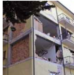
Fig. 1 ESPULSIONE DELLA MURATURA DI TAMPONAMENTO DAL TELIAIO
