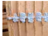
Fig. 3 - LA MALTA PENETRA DEI FORI CREANDO UN COLLEGAMENTO INTIMO TRA I DUE CORSI DI BLOCCHI
